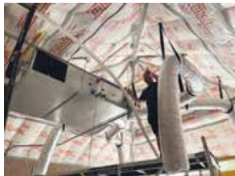
De klaslokalen worden voorzien van een systeem dat zorgt voor ventilatie, verwarming en koeling.
